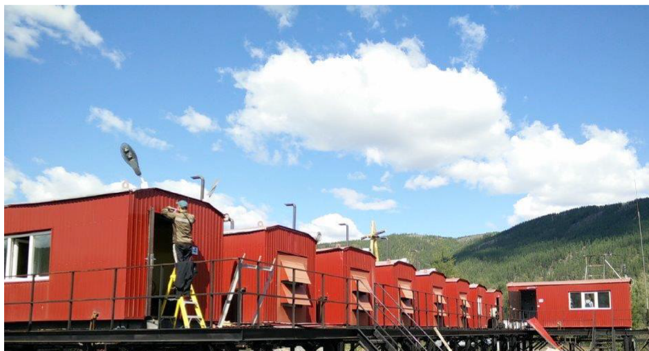
Рис. 2. Дизельная электростанция, село Себян-Кюель Кобяйского улуса Олекминского района.
