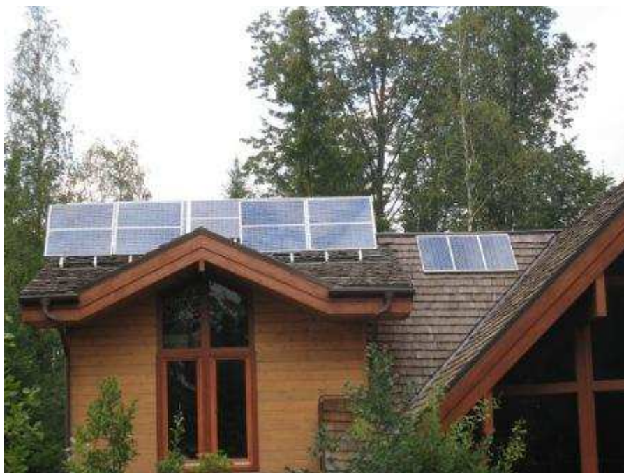
Рис. 3. Солнечная электростанция 2280-48/4,5 кВт.
